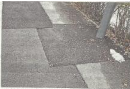
Solche Ausbesserungen von Gehwegen wie hier an der Salzburger Straße hält die Bürgerliste für inakzeptabel. – Foto: Bürgerliste
